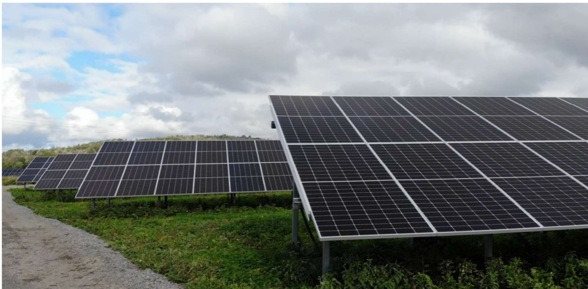
Figur 44 - Eksempel på bakkemontert solkraftanlegg (kilde: solcellespesialisten).
