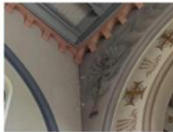
Kor: Blæring og avskalling av maling på innside av vegg.
