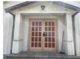
Kapell: Generelt slitt overflatebehandling på panel og ytterdører.
