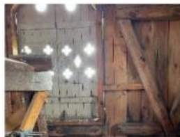
Kirketårn: Bæresøyle er fjernet i område tilstøtende råteskadet bjelkelag.
