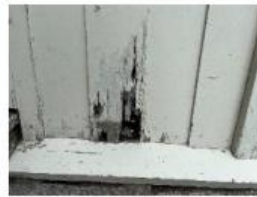
Kirkebygg: Avflasset maling og råteskadet kledning.
