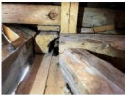
Kirketårn: Råte i bjelkelag i etasjeskiller.
