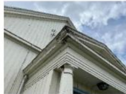
Kapell: Råteskader i gesims og utsmykking.
