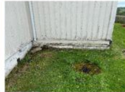
Kapell: Råteskader og avskallet maling på panel og vannbord.
