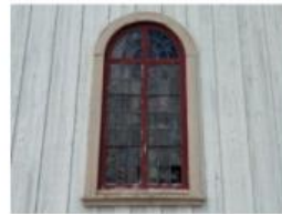
Kapell: Vindu som bærer preg av slitasje og manglende vedlikehold.
