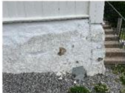
Kirkebygg: Nye skader i grunnmur som var rehabilitert for få år siden.
