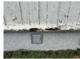
Kapell: Avflasset maling og råte på vannbord og panel.
