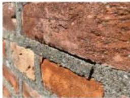
Kirkebygg: Avskalling av tidligere reparerte mørtelfuger.
